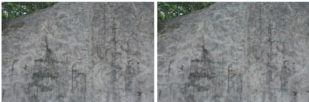
AIによるひび割れ自動検知例
