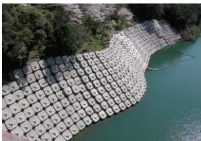
グラウンドアンカー
