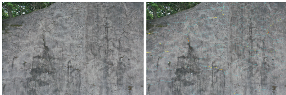
AIによるひび割れ自動検知例
