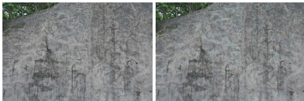
AIによるひび割れ自動検知例
