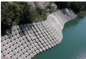
グラウンドアンカー
