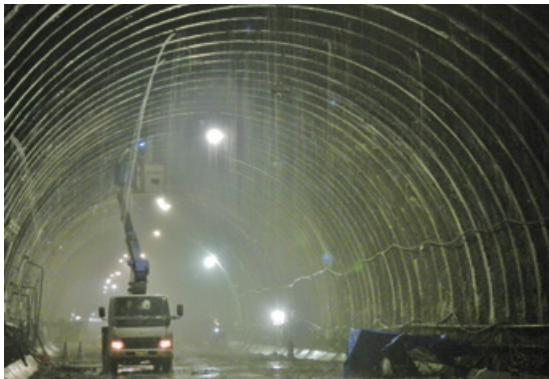
坑内の湧水状況
