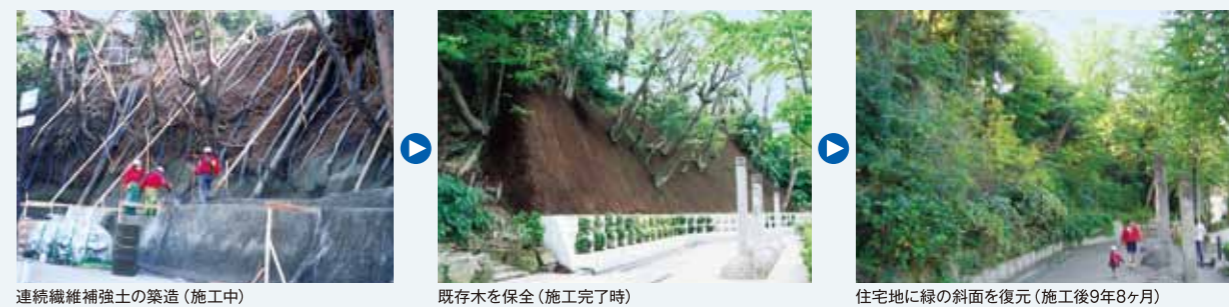
連続繊維補強土の築造(施工中) 既存木を保全(施工完了時) 住宅地に緑の斜面を復元(施工後9年8ヶ月)
