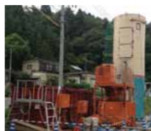
スラリープラント (60m 2 程度)
