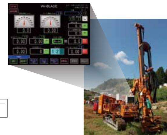
制御システム操作パネル
