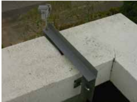
写真-4 構造物に設置したプリズム
