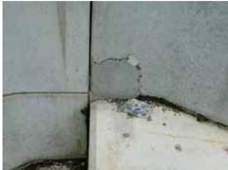
写真-6 基礎との境界部に欠け（茂庭沢）
