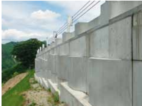
写真-5 壁面状況（烏帽子の2, H=2.0-4.0m）
