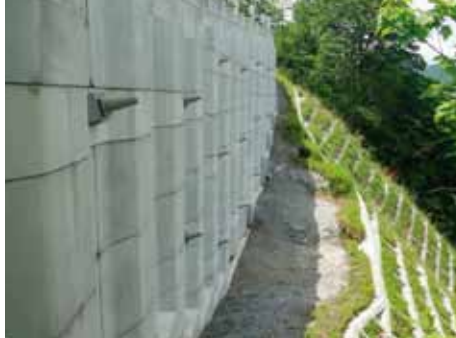
写真-4 壁面状況（オーレン, H=1.5-8.0m）
