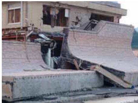
写真-6 地震後の山田漁港の状況 (H23.6.29)
