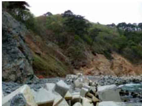
写真-6 地震後の状況 (H23.5.10)
