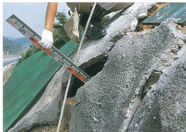
既設吹付けコンクリートの破損状況(昭和60年)
