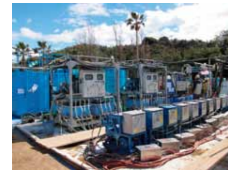
▲注入ユニット
